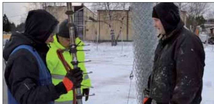
Uutta aitaa viimeisteltiin kipakassa pakkasessa. Veneparkki-projektin vetäjä Kimmo Koskinen (keskellä) tutkii viimeistä osuutta yhdessä aita-asentajien eli Sami Kelan (vas.) ja Sam Silfveniuksen kanssa.
